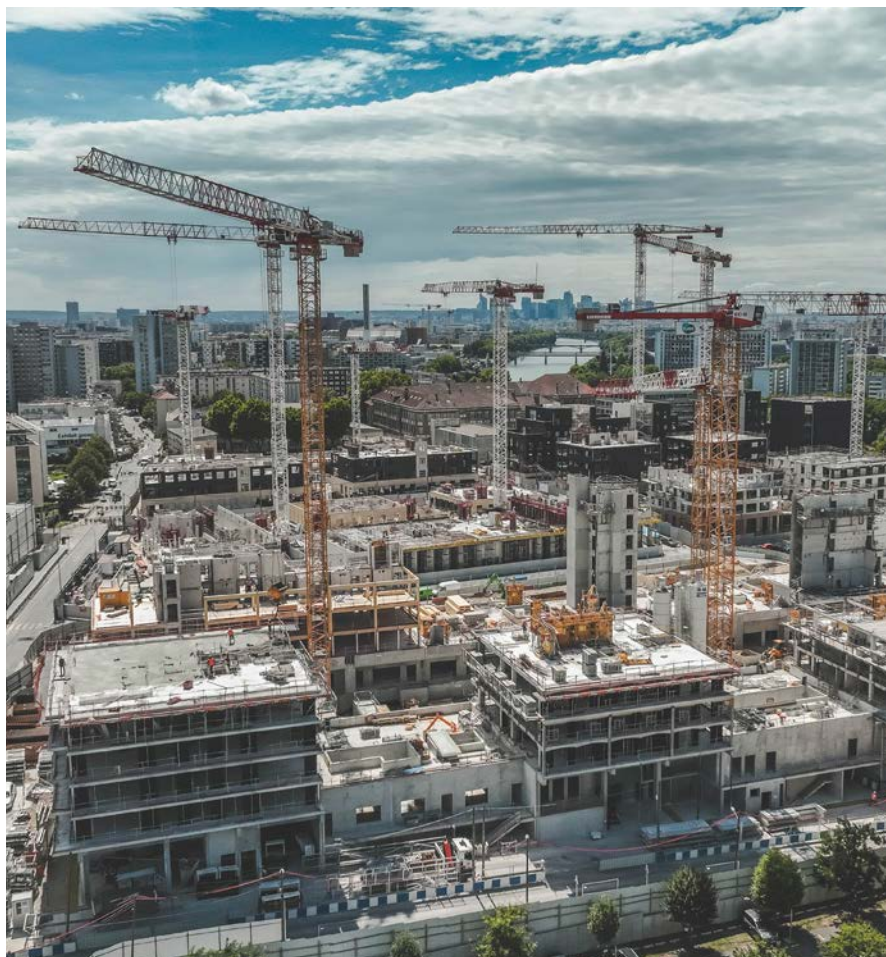
Universeine - Le Village des athlètes, un chantier confié à Alphi par les entreprises Vinci, Spie Batignolles, GCC, Bouygues Habitat résidentiel Paris Ouest et Eiffage Construction.
